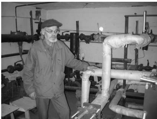
Реконструированный тепловой пункт в ТСЖ «Содружество», г.Пермь
